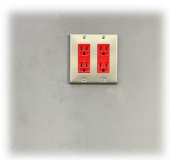
【非常用コンセント】
