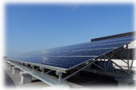
【太陽光発電設備】
