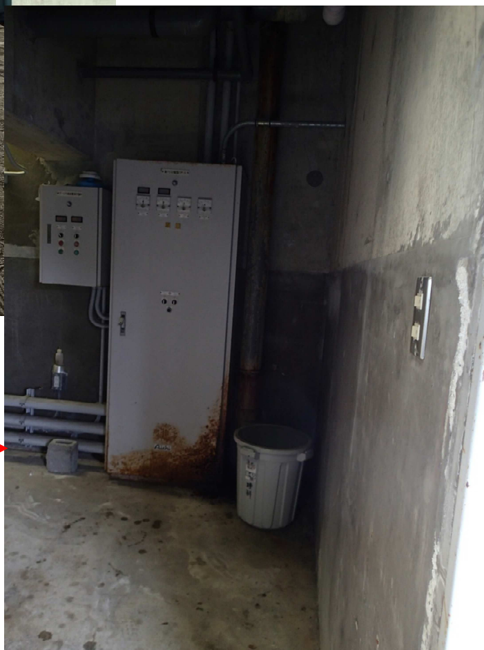
機械室漏水状況 (バケツ設置)
