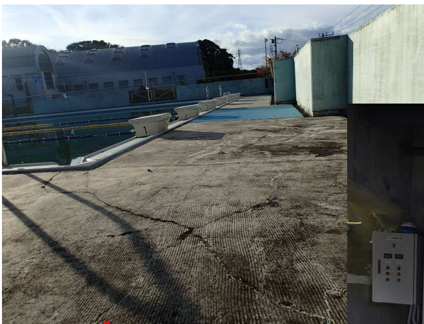
甲羅干し塩ビシート一部撤去、亀裂状況
