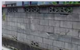
危険ブロック塀
