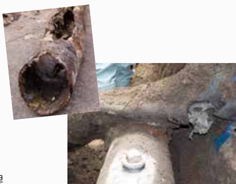
▲老朽化した下水管
