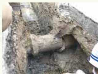
老朽化で割れた汚水管
