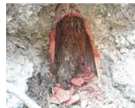
木の根が詰まった下水道管。ティッシュやおむつが詰まっていたことも
