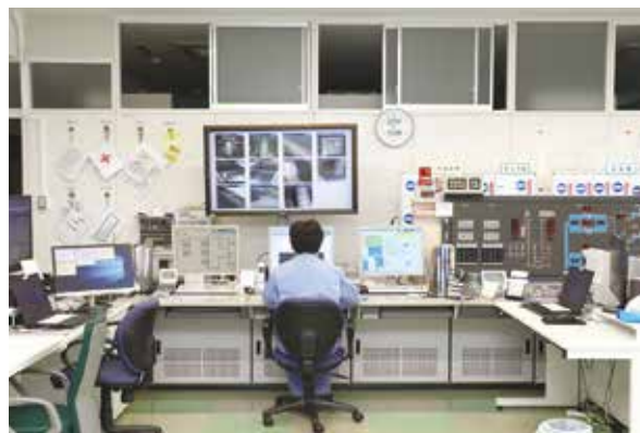
浄水管理センターと市内2か所の中継ポンプ場を一括管理
