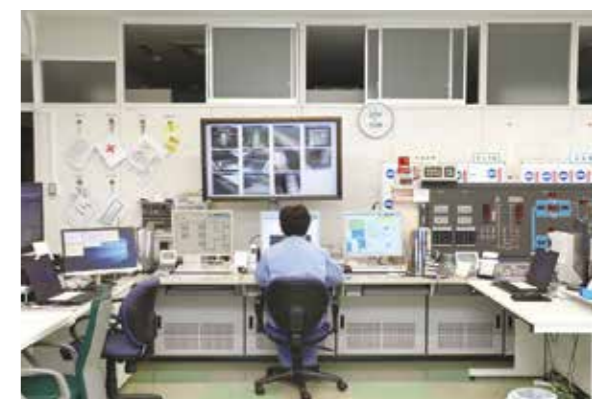
浄水管理センターと市内2か所の中継ポンプ場を一括管理
