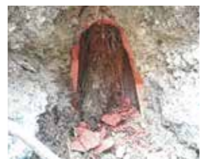
木の根が詰まった下水道管。ティッシュやおむつが詰まっていたことも
