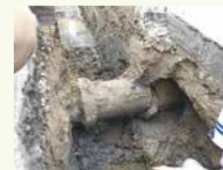
老朽化で割れた汚水管
