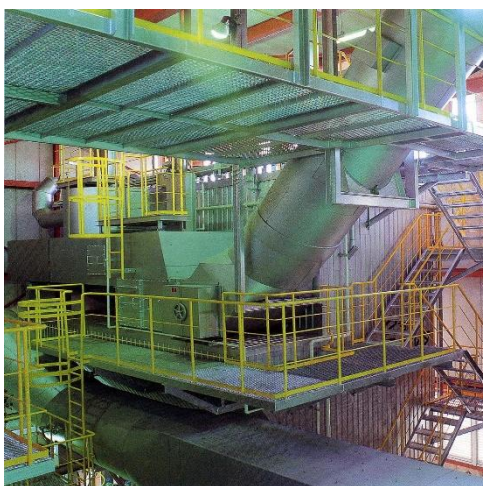
焼却処理施設のバグフィルター
