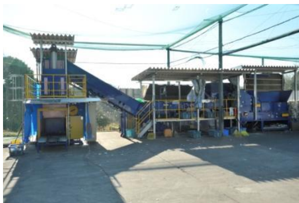
容器包装プラスチック選別処理施設
