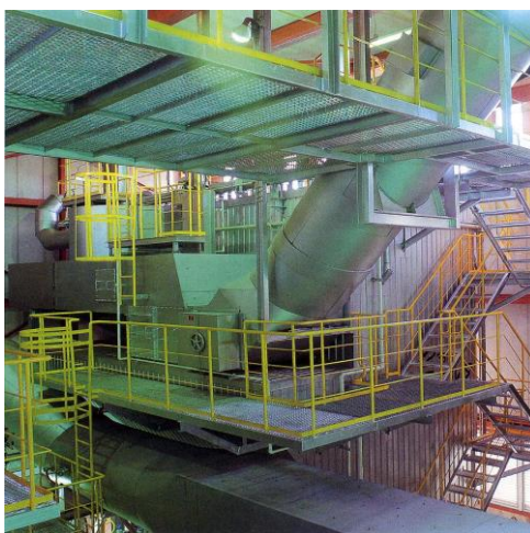
焼却処理施設のバグフィルター
