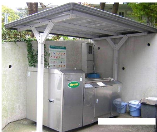
設置場所：ファミリー逗子 処理能力：30 kg/日 設置年月：平成 15 年 3 月
