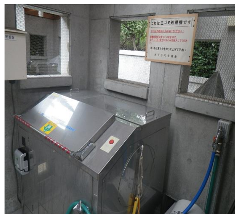
設置場所：市営池子住宅 処理能力：30 kg/日 設置年月：平成 26 年 3 月
