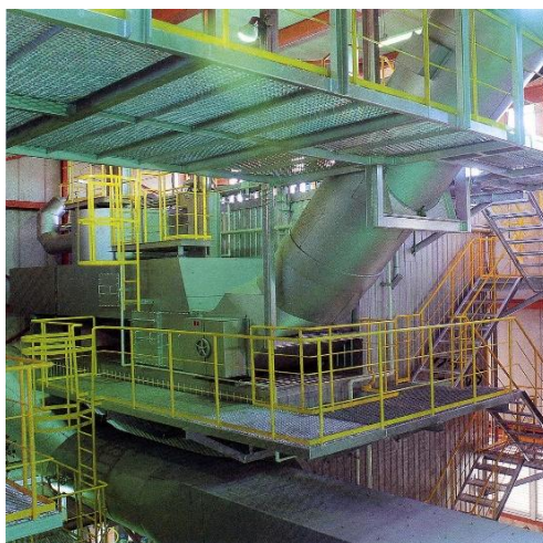
焼却処理施設のバグフィルター
