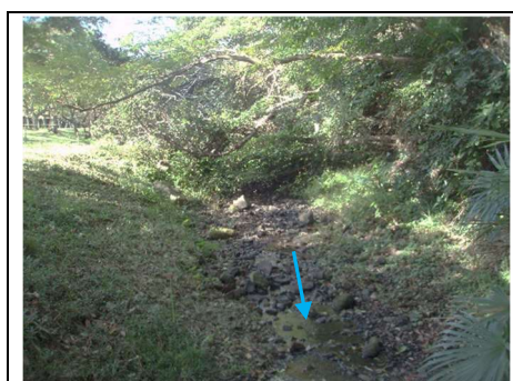
図3-17 水路を塞ぐ倒木(久木池下流①) (2020年9月30日撮影)
