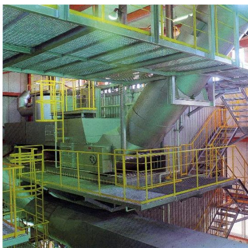
焼却処理施設のバグフィルター
