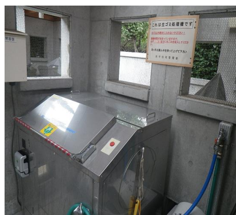
設置場所：市営池子住宅 処理能力：30 kg/日 設置年月：平成 26 年 3 月
