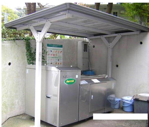
設置場所：ファミリー逗子 処理能力：30 kg/日 設置年月：平成 15 年 3 月
