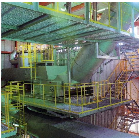
焼却処理施設のバグフィルター
