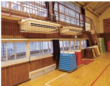
小中学校体育館の空調設備（八潮市HPより）
