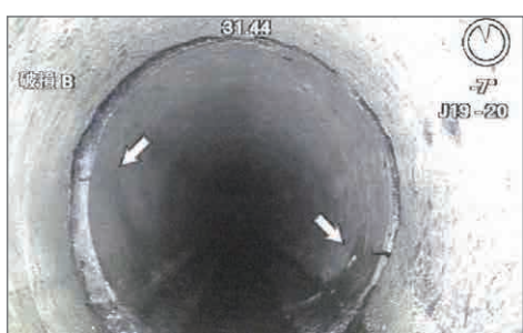
老朽化した下水道管
