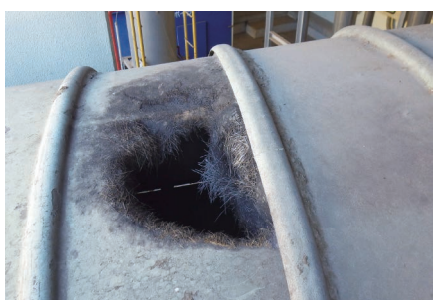
火災で穴が空いた施設
