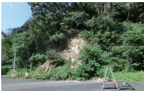
共同使用地内の崩落現場
