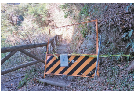
散策路の亀裂が広がり 現在、通行止（令和3年1月）
