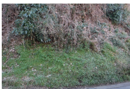
市内には多くの危険崖地箇所が
