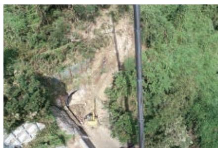
台風15号により土砂崩れが発生した小坪トンネル
