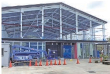
外壁を飛ばされた 鋸南町の道の駅
