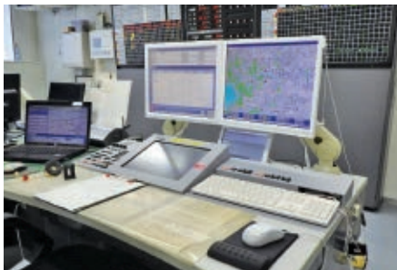
逗子市消防本部 通信指令室
