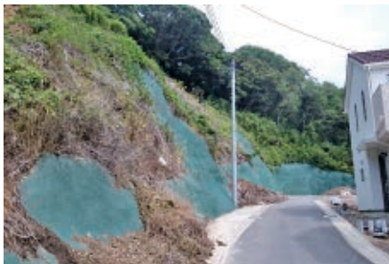
新宿の崖崩落…市長にしかできない対応がある
