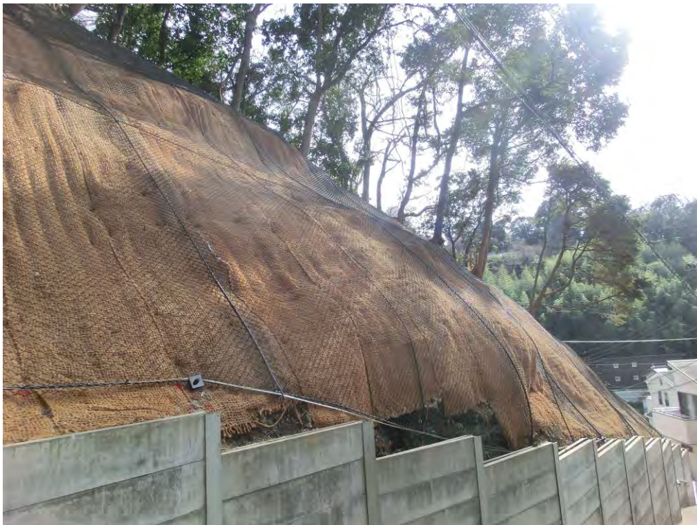
令和3年度実施 落石防護網設置工による施工例（小坪1丁目地内）
