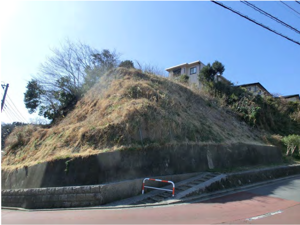
令和3年度実施 落石防護網設置工による施工例（久木6丁目地内）
