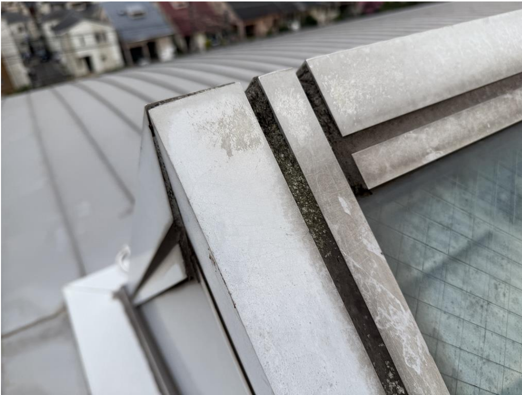
シーリングの劣化状況
