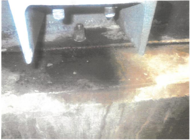
受水槽漏水状況
