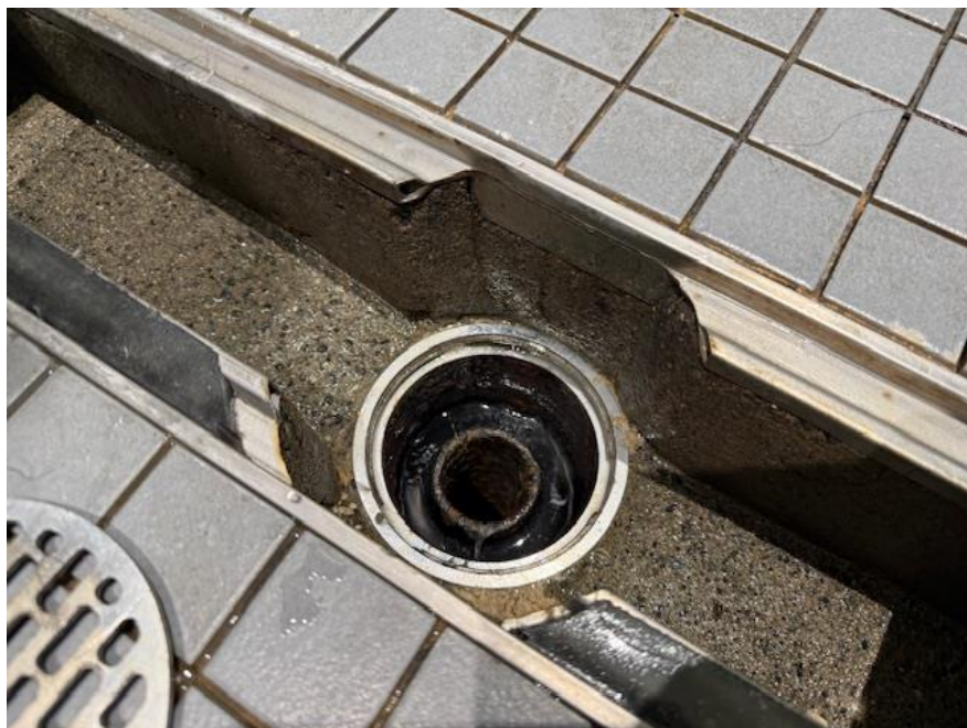
⑯ 排水溝の蓋を取り外した現在の参考例
