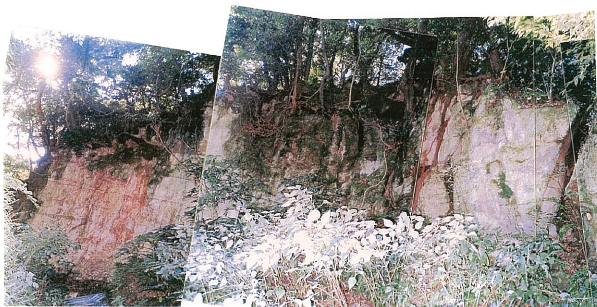
写真 6－3－9 サイトB及びサイトCの壁面上部肩付近の樹木の状況
