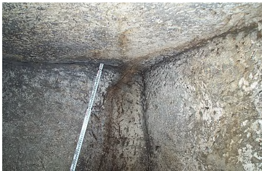
P-5 左、奥 天井 クラック
