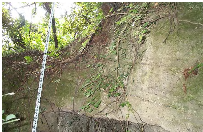
P-3 上部、根 欠損 クラック
