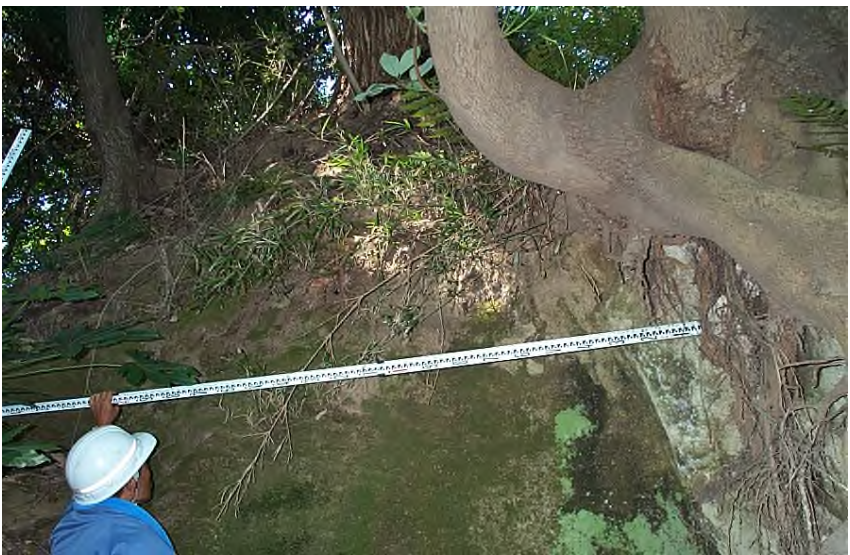
P-3 天井欠損
