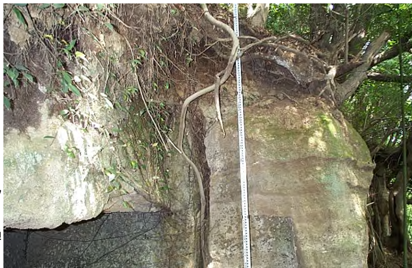
P-5 右、手前 根、クラック 上部 表土、欠損
