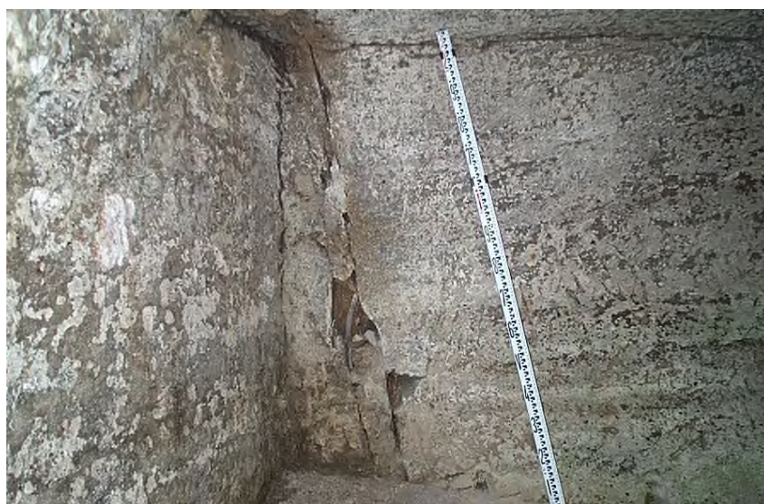
P-6 右、奥 天井 クラック
