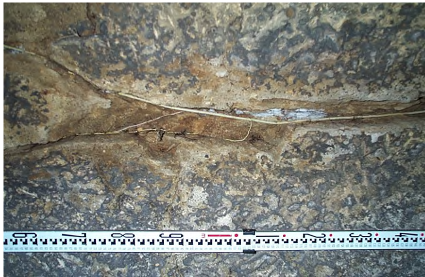
P-4 天井 クラック
