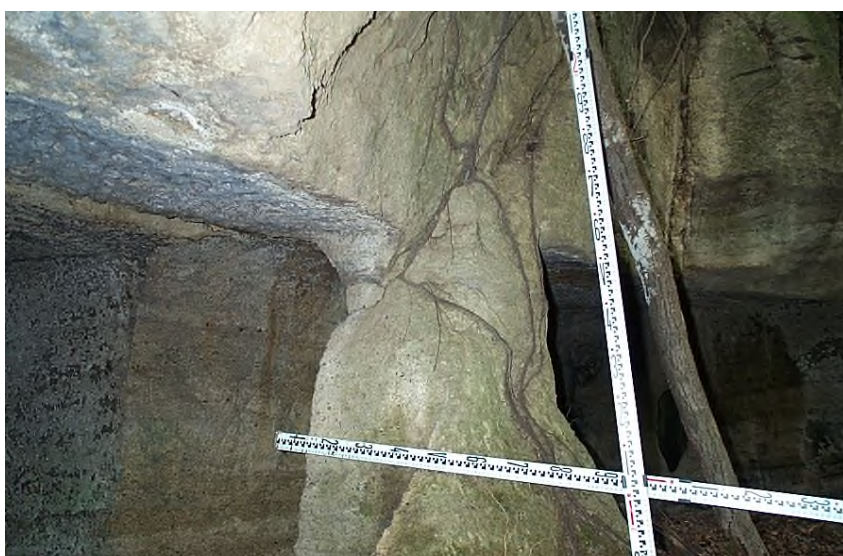
P-9 右、前 欠損、根 クラック
