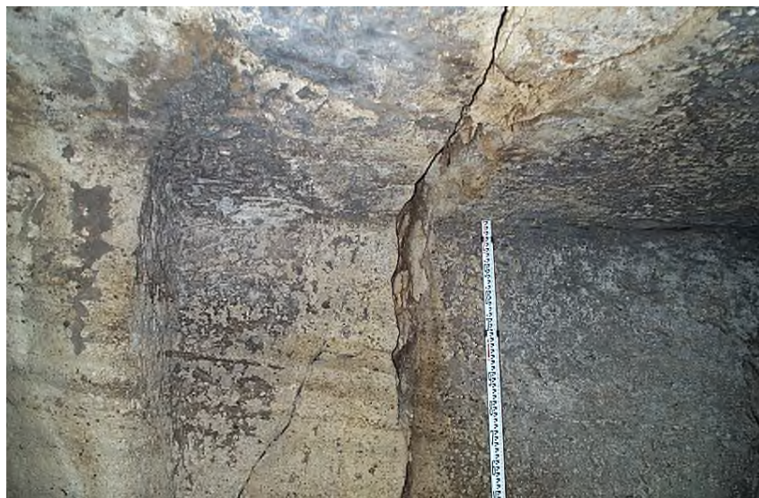
P-4 左、手前 天井 クラック
