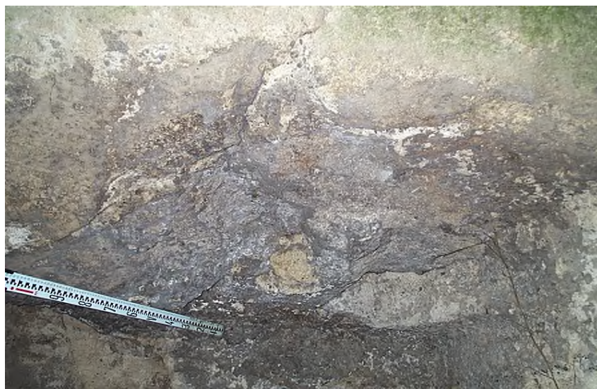
P-5 天井 欠損 クラック
