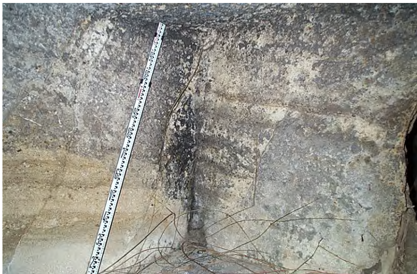
P-4 正面左側 クラック
