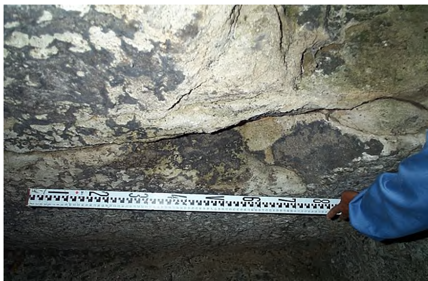
P-4 天井 欠損
