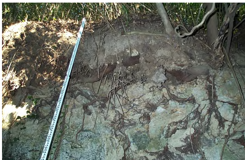
P-3 天井 木根の オーバー ハング
