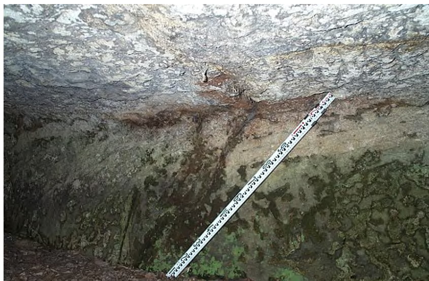
P-4 正面～ 天井 クラック
