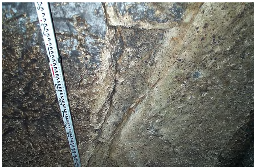
P-8 天井欠損
