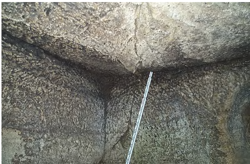
P-4 正面天井 クラック
