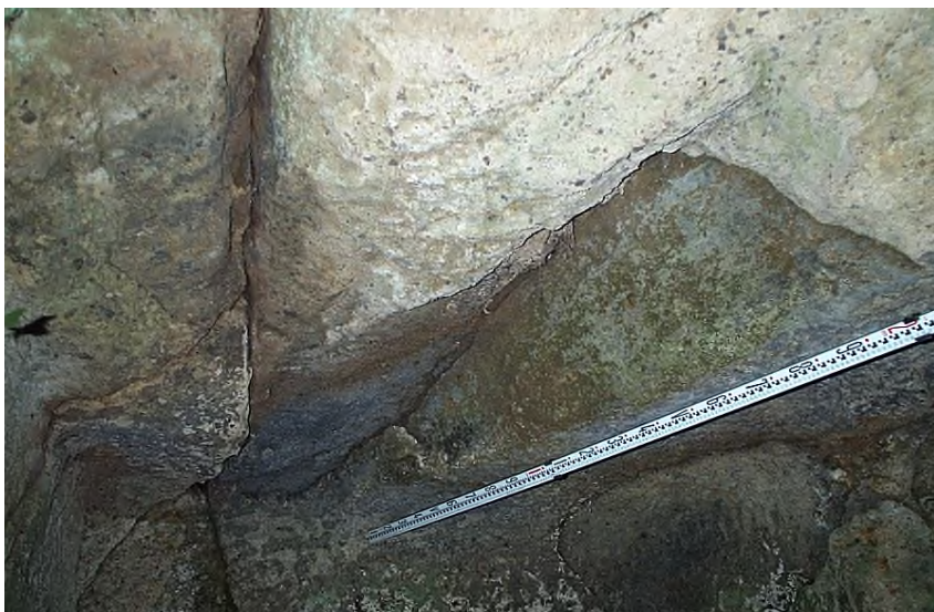
P-8 天井 欠損 クラック
