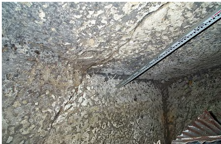
P-3 左、天井 クラック
