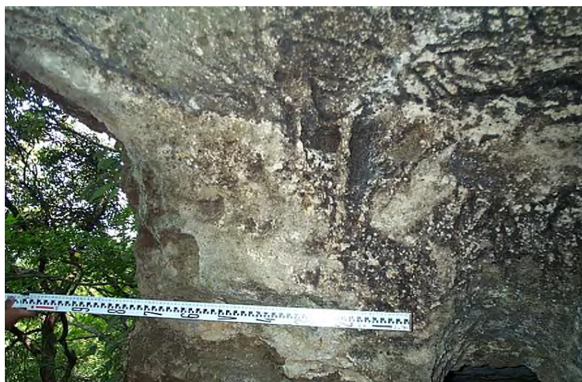
P-2 左壁手前 欠損
