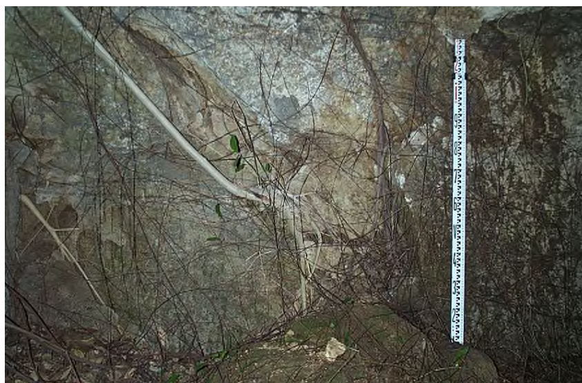
P-4 左壁剥離 木根
