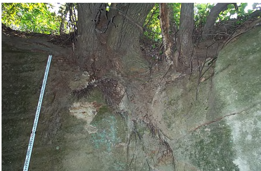
P-3 上、木根 吹き抜け 右側クラック
