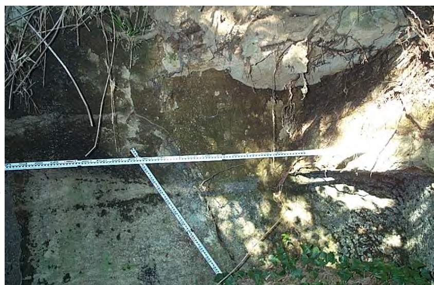
P-3 正面の クラックと 天井欠損
