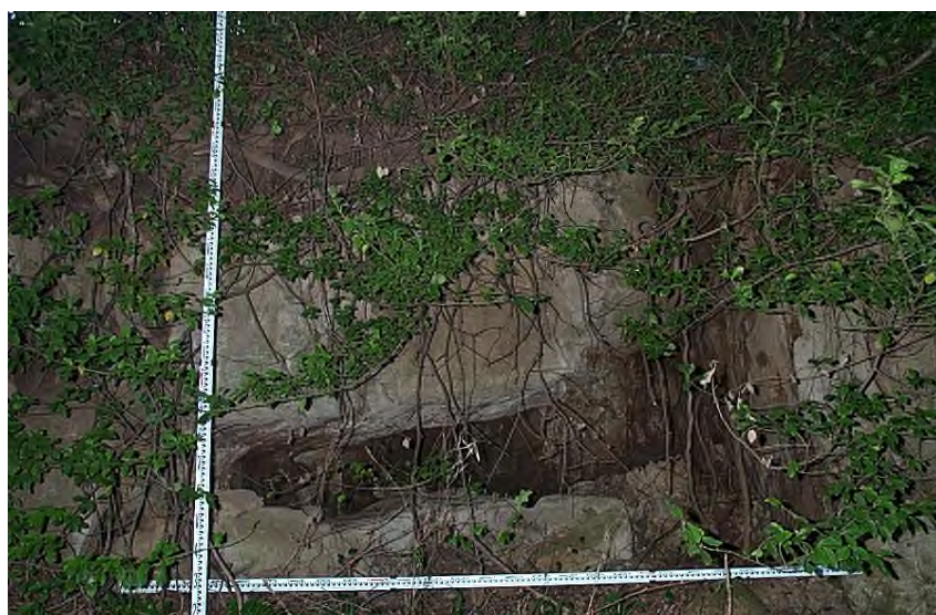
P-3 正面天井 欠損
