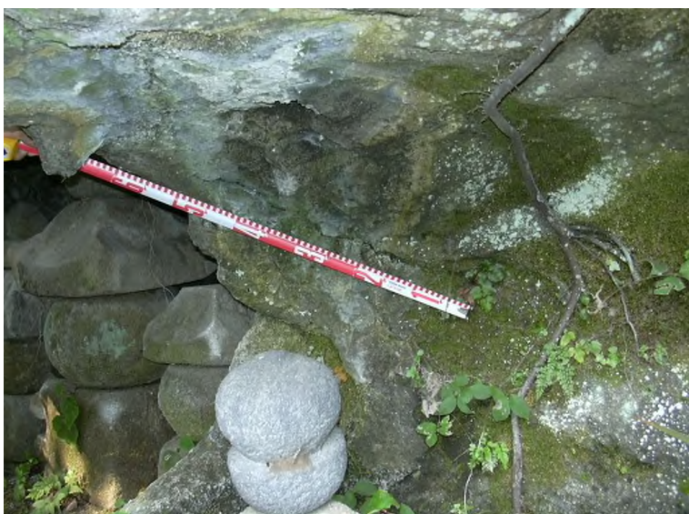
P-3 正面壁の クラック
