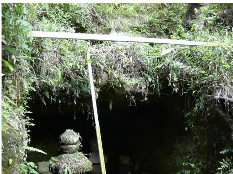
P-3 天井欠損
