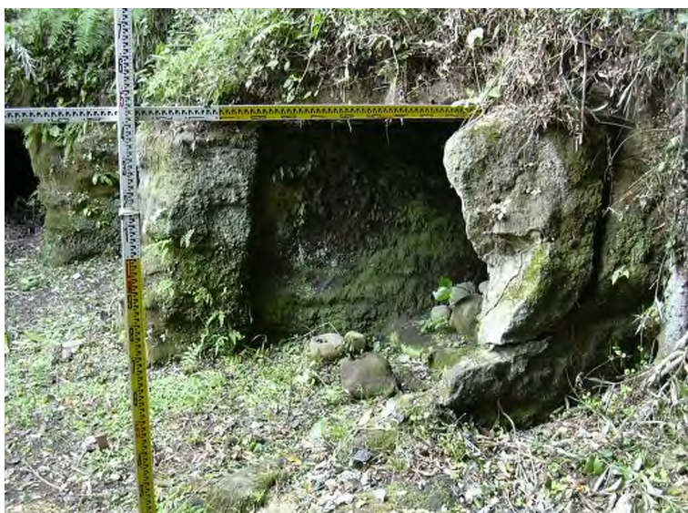
P-3 右壁、 天井 欠損
