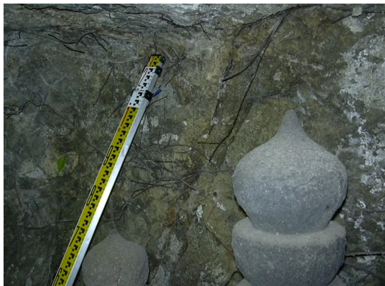
P-4 正面壁 クラック
