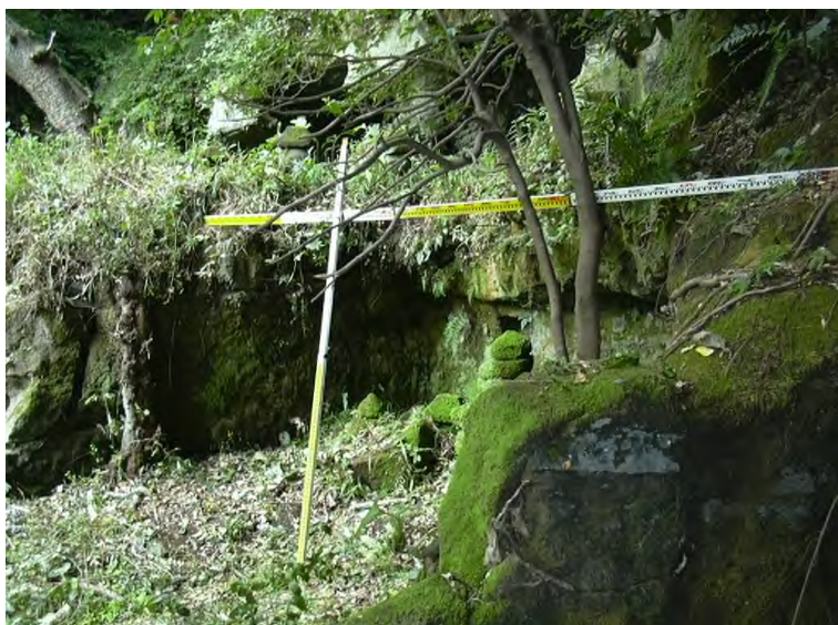
P-5 天井欠損
