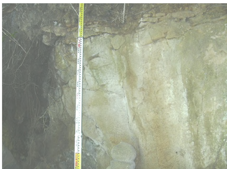
P-6 正面壁 剥落 クラック
