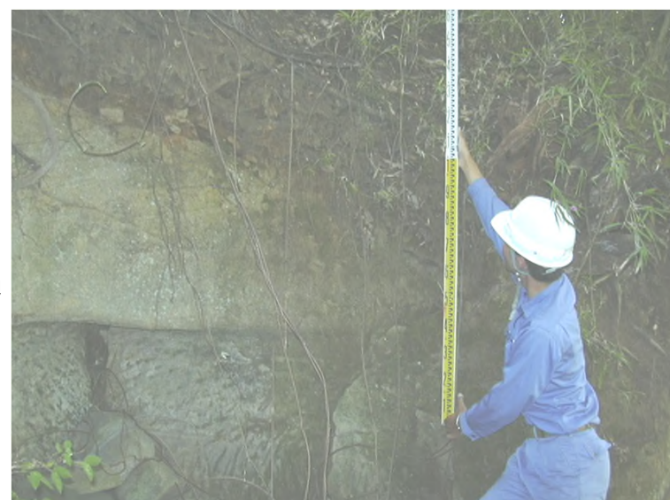
P-6 天井欠損
