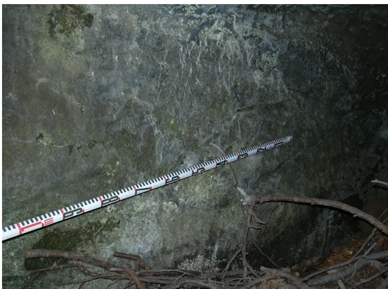
P-3 左壁の クラック
