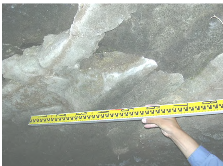
P-6 天井剥離
