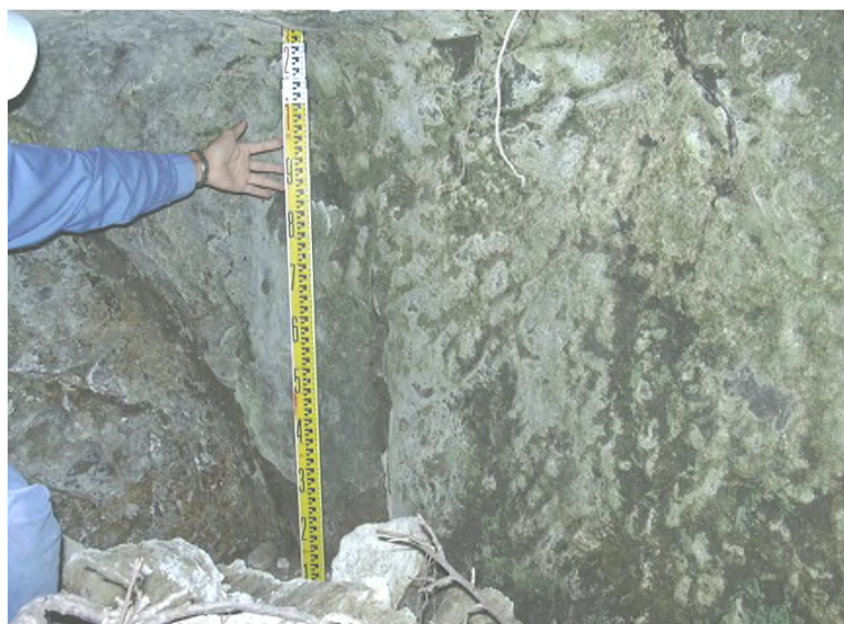
P-2 右壁奥 クラック 剥離
