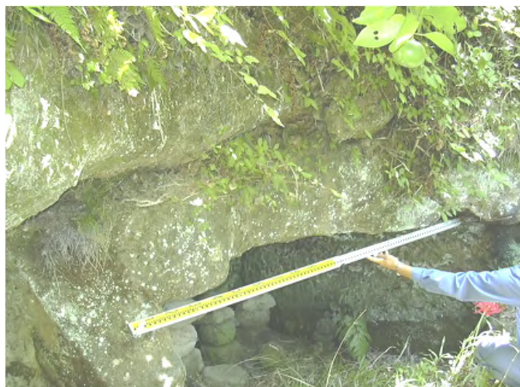
P-5 天井欠損
