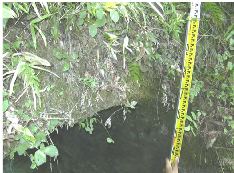
P-5 天井欠損
