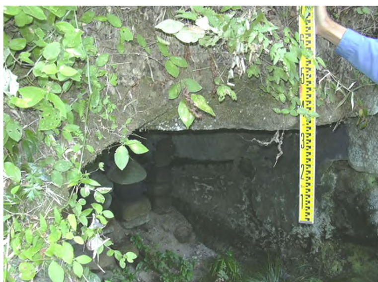
P-7 天井欠損
