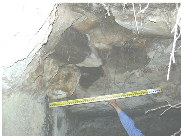
P-6 天井剥落
