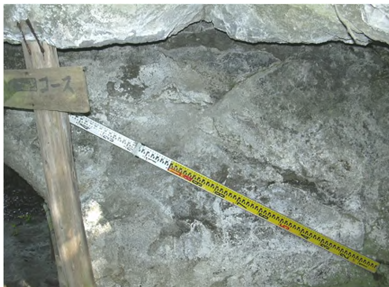
P-5 正面壁 クラック
