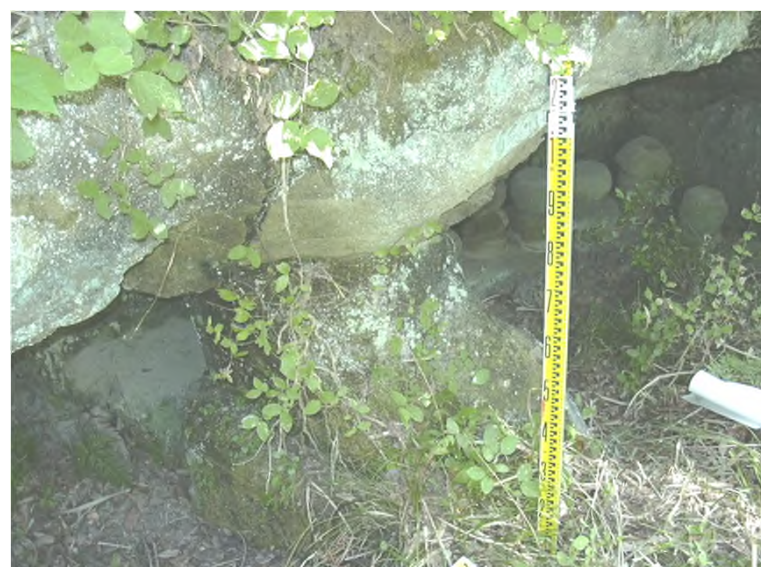
P-3 右壁欠損 木根 クラック
