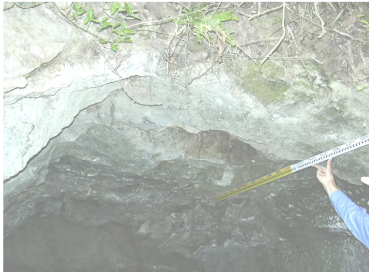
P-5 天井欠損
