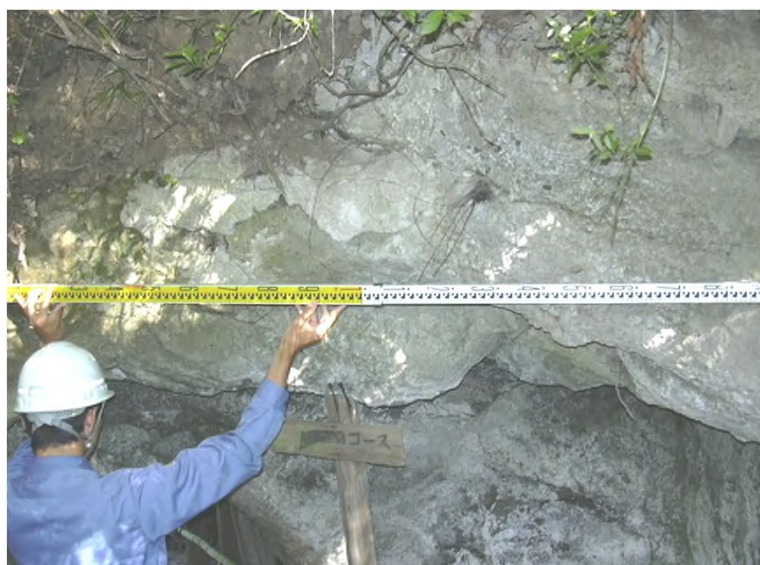
P-4 屋根 クラック
