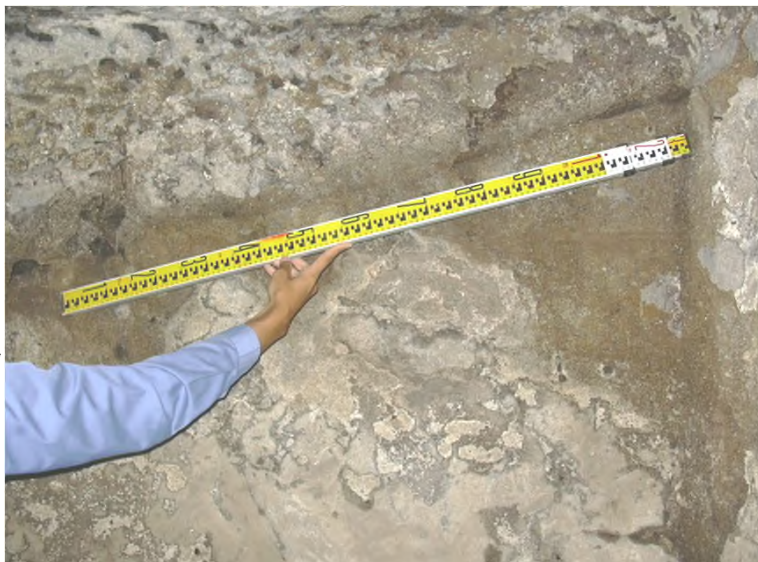
P-5 正面 剥離クラック
