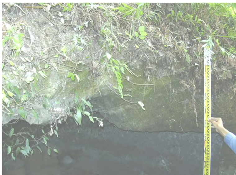
P-5 天井欠損
