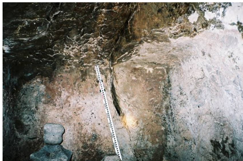
P-3 正面壁 クラック
