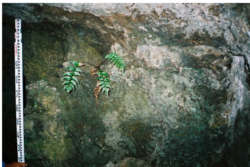
P-3 正面壁 剥離
