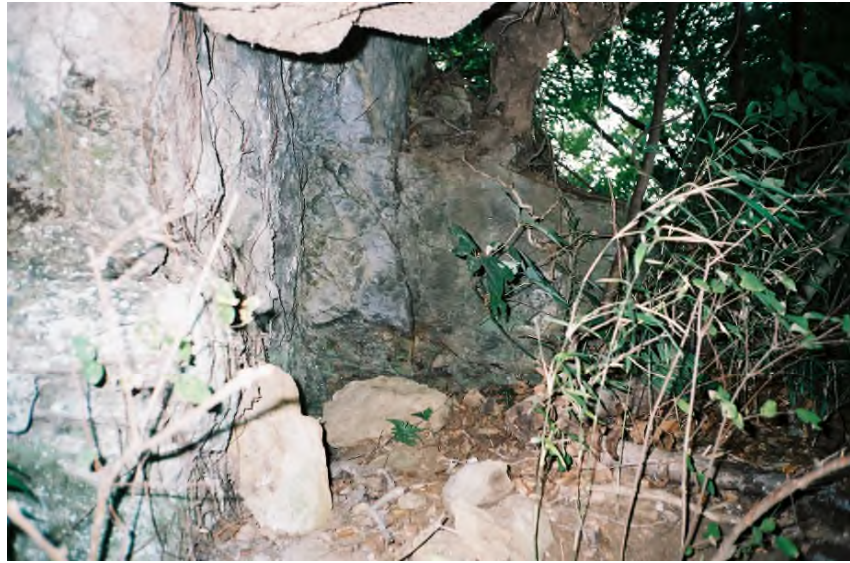
P-4 右壁の クラック
