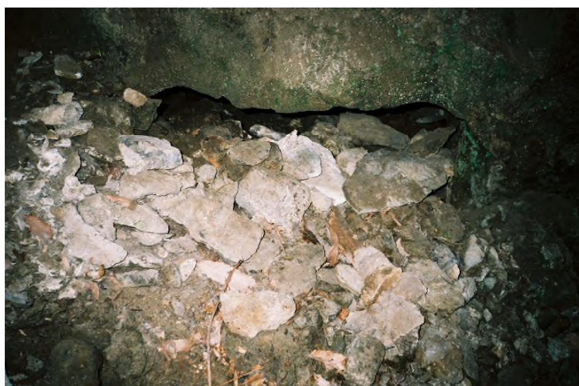
P-3 土砂堆積 状況
