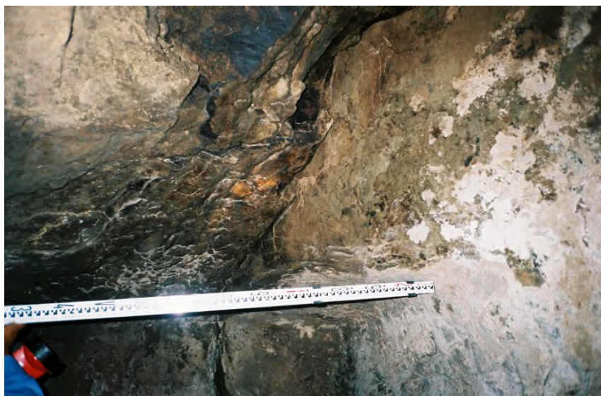
P-6 天井欠損
