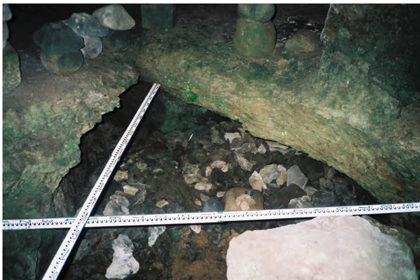
P-4 天井の 欠損
