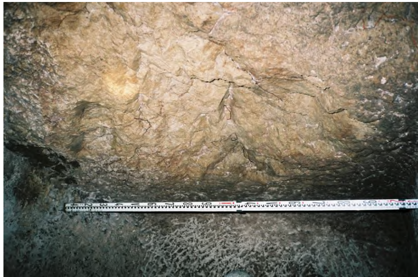
P-4 天井剥離
