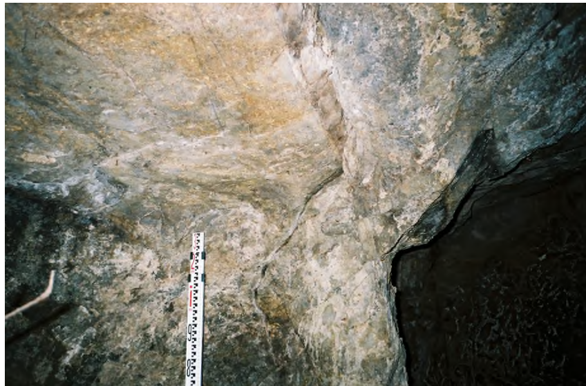
P-5 奥壁～ 天井の クラック
