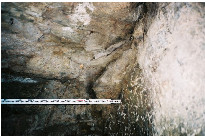
P-5 右壁の クラック 及び 天井欠損
