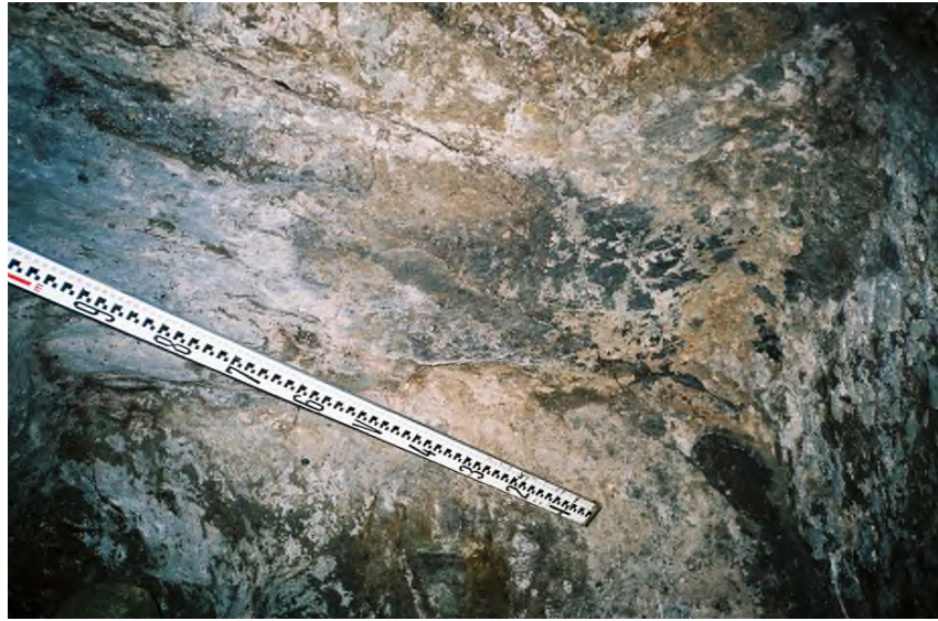
P-4 天井 クラック
