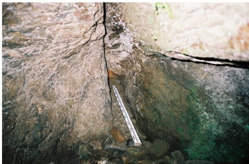
P-3 左奥 クラックに 沿う欠損
