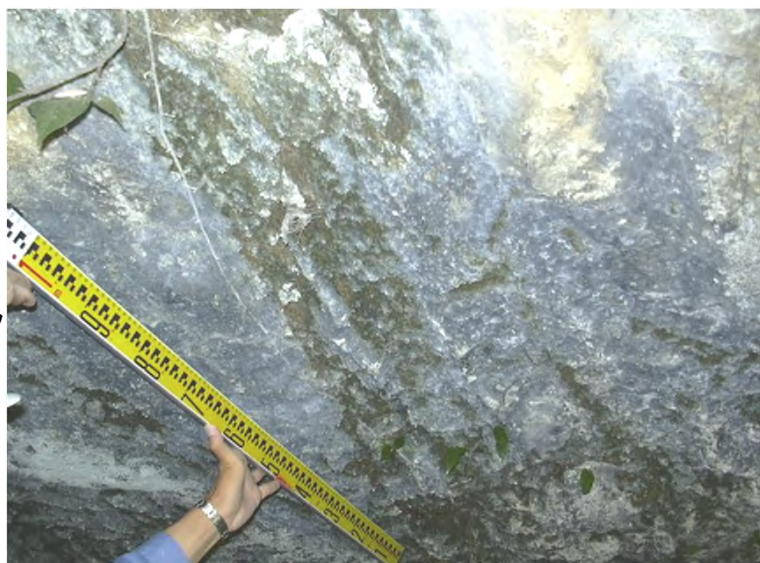
P-6 天井クラック
