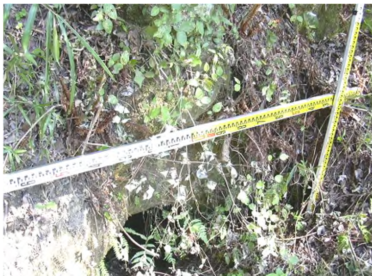
P-2 天井欠損
