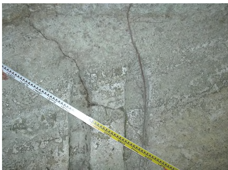
P-3 右壁の クラック
