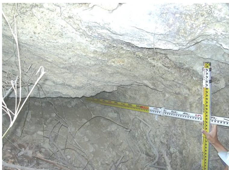
P-3 天井剥落
