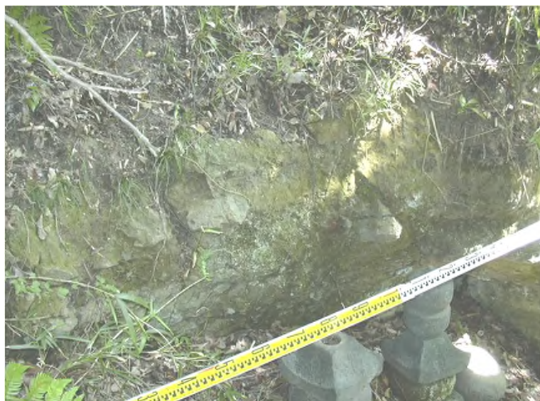
P-5 天井欠損
