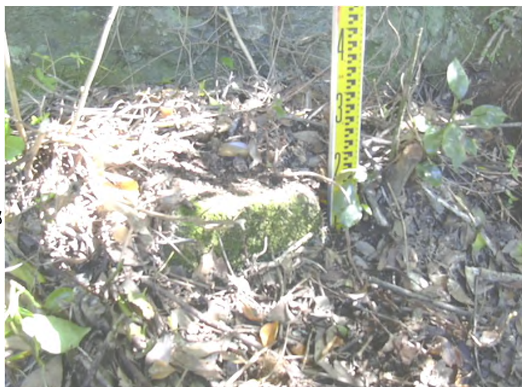
P-5 正面壁上部 木根 クラック
