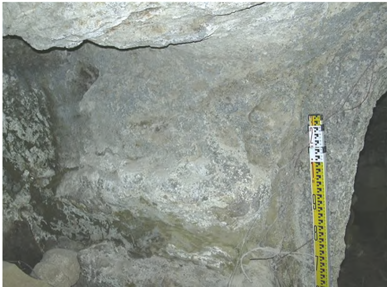
P-5 右壁の溝 剥離 欠損
