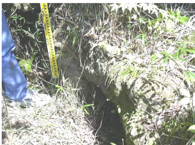
P-3 天井欠損 木根手前
