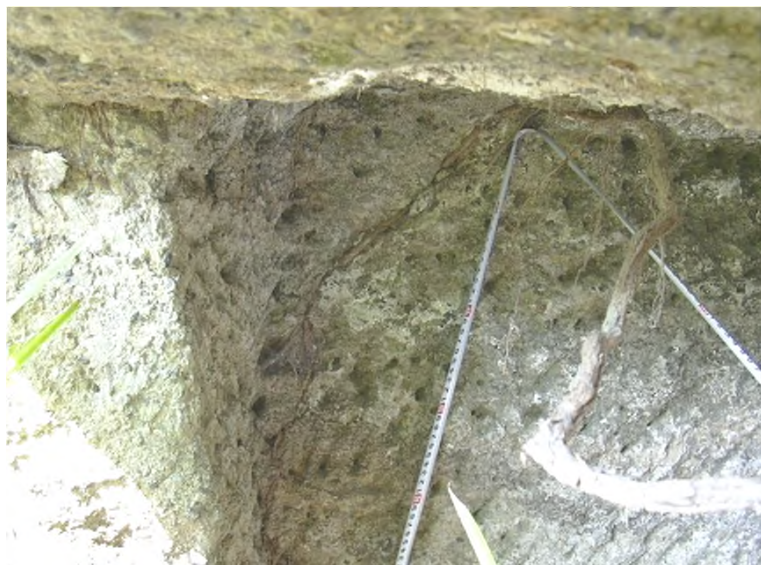
P-3 左壁 クラック (手前)
