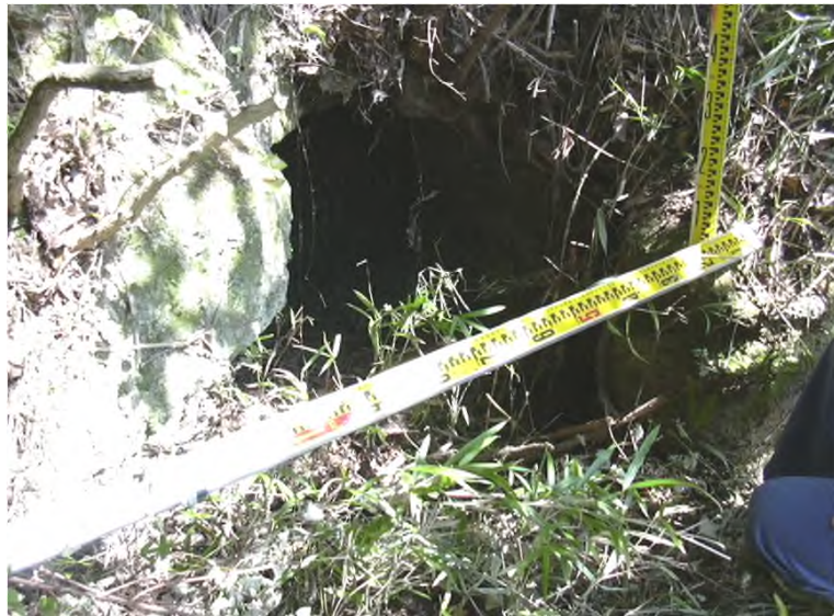
P-2 天井欠損 木根
