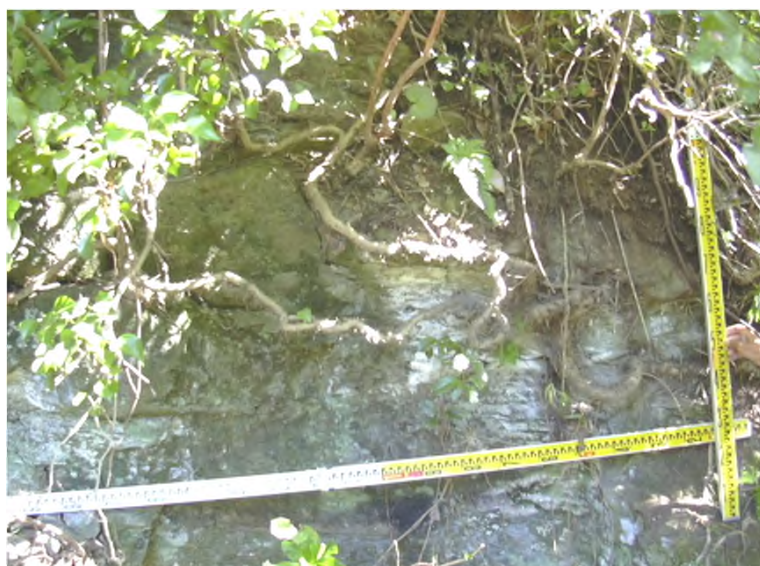
P-4 天井欠損 木根
