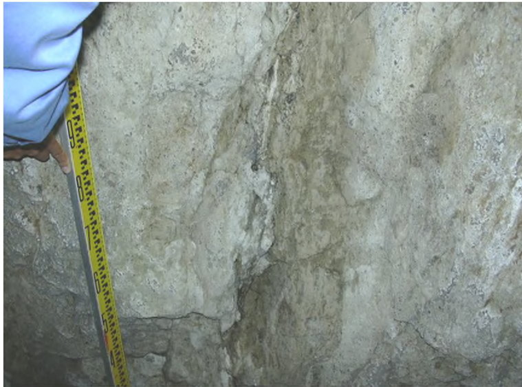
P-4 天井 クラック 正面の溝
