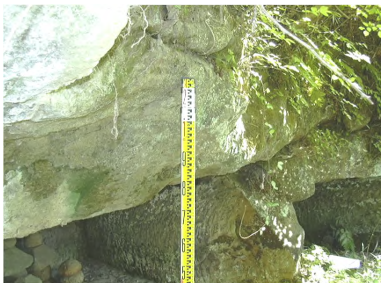
P-7 天井欠損
