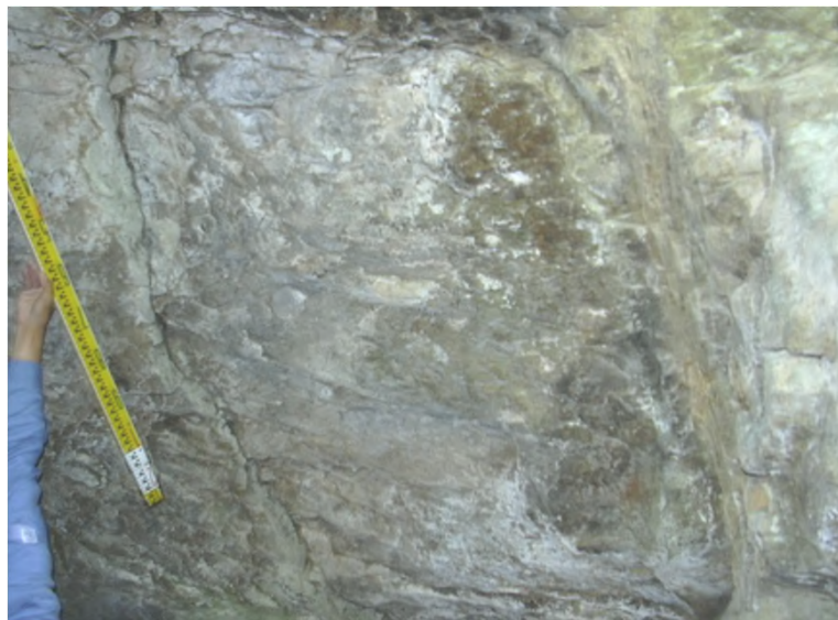
P-6 天井剥離
