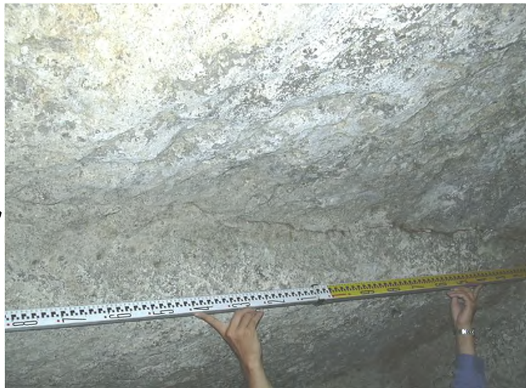
P-5 天井クラック
