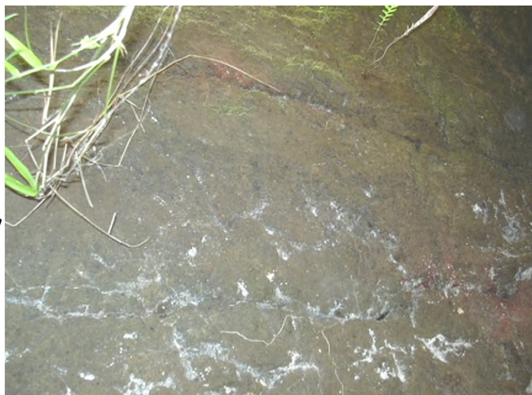
P-5 天井クラック
