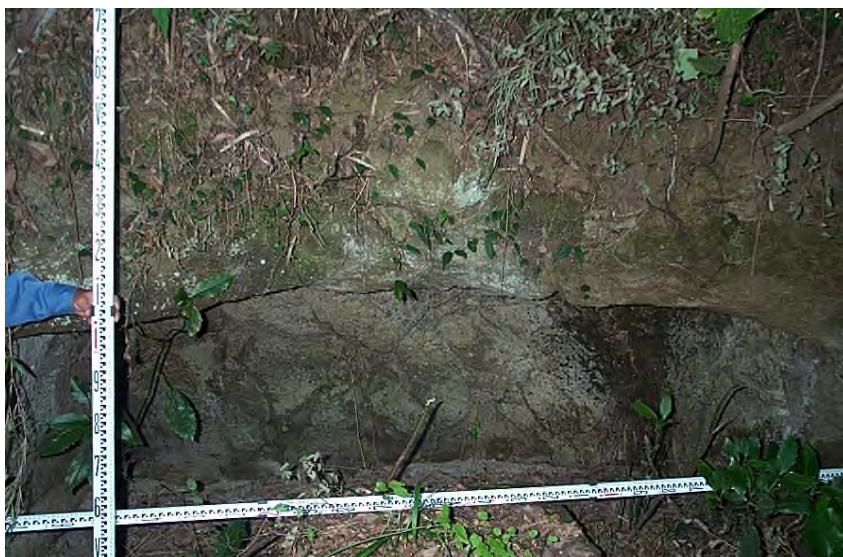
P-4 天井欠損
