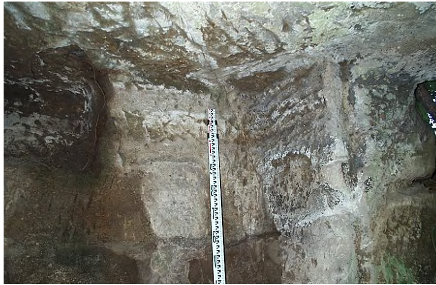
P-7 右壁～ 天井の クラック
