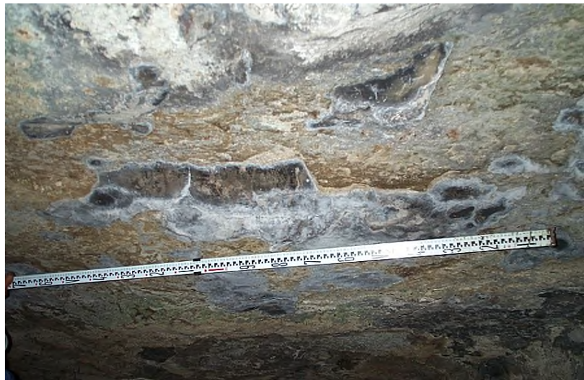
P-5 天井 クラック 補修跡
