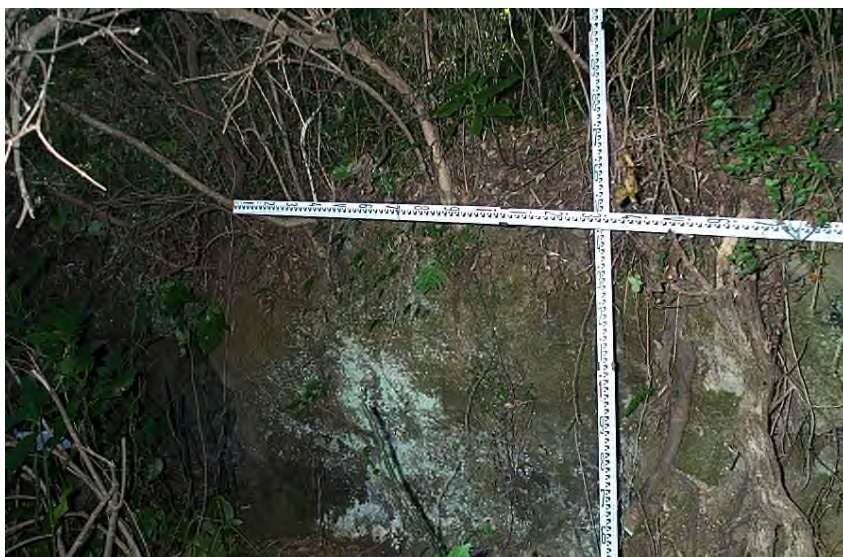
P-4 天井欠損
