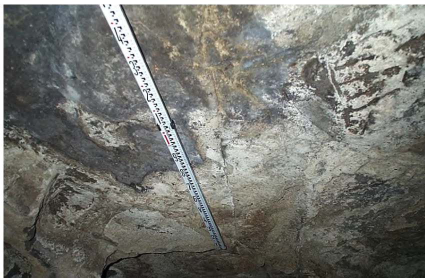
P-6 天井 クラック
