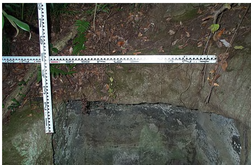
P-7 入り口 天井 欠損
