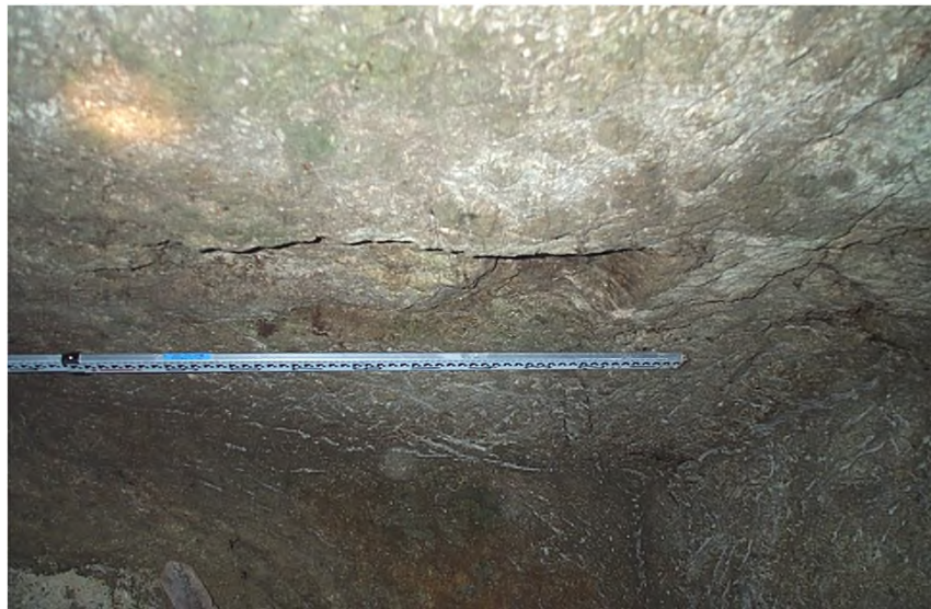
P-4 天井剥離
