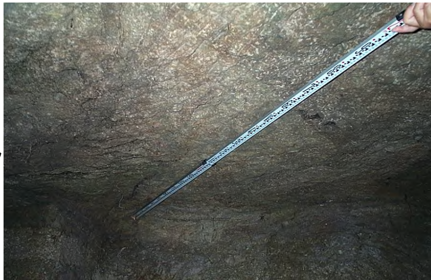
P-5 天井クラック
