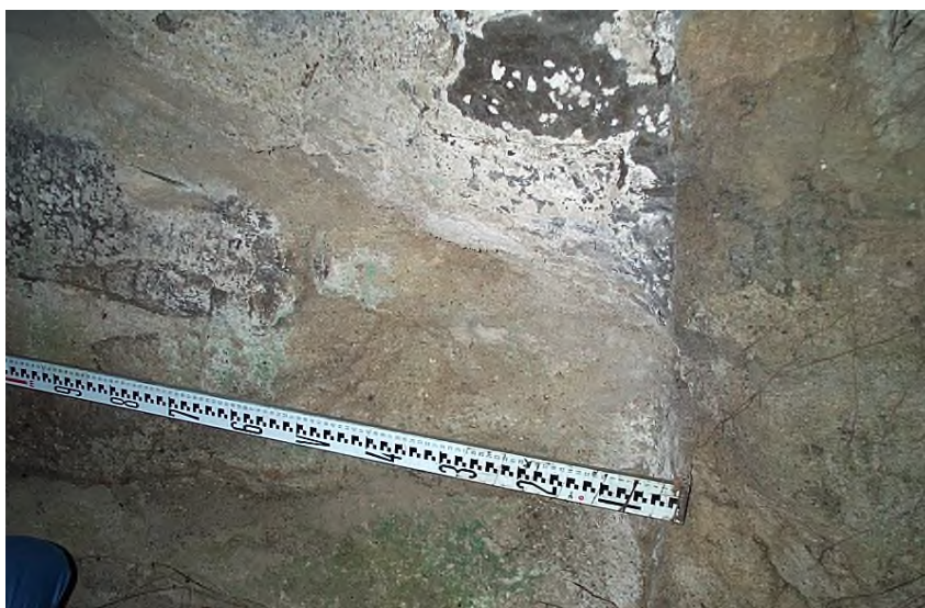
P-6 右手前 剥離
