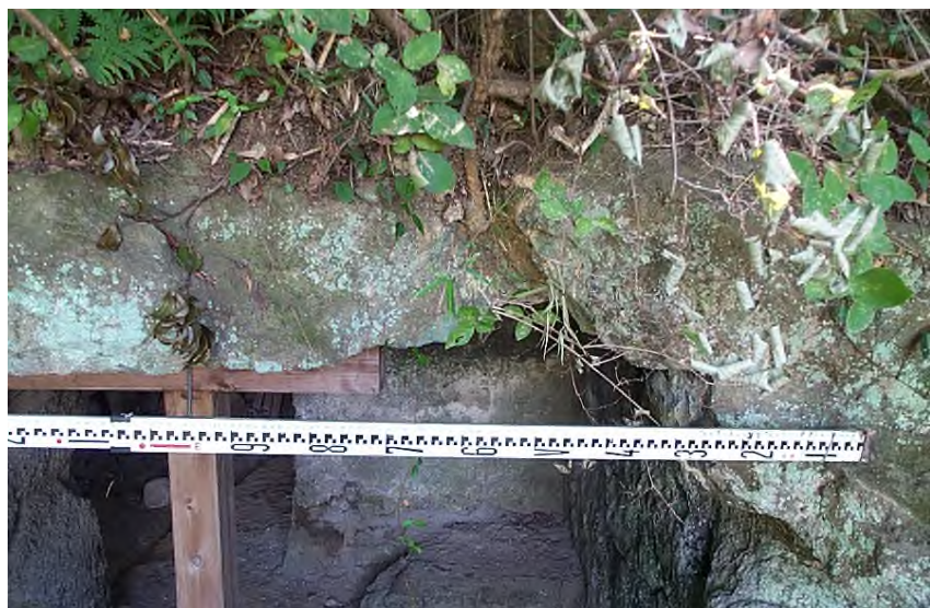
P-6 天井欠損
