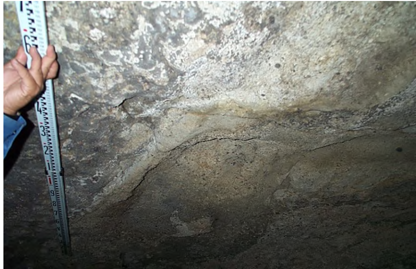
P-5 天井 クラック
