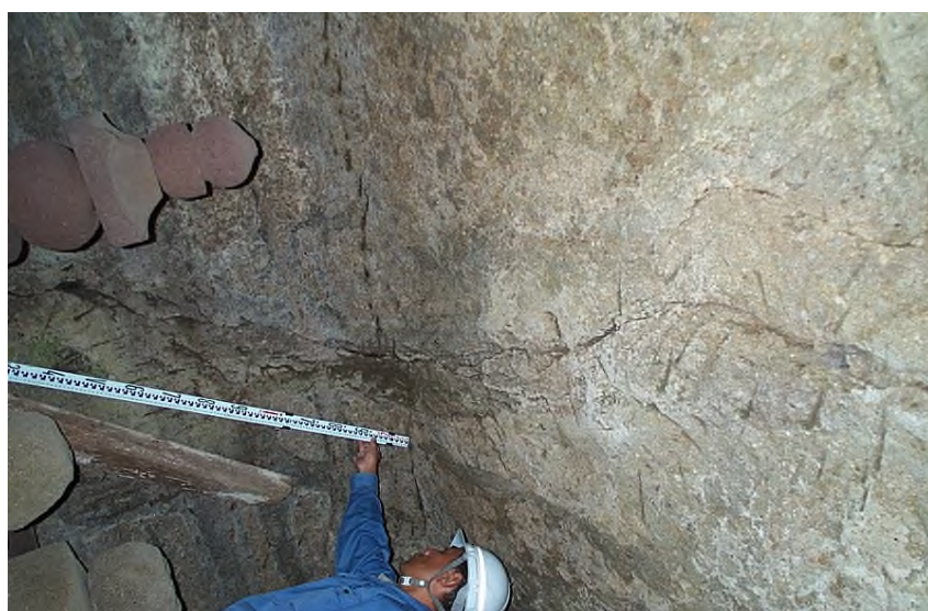
P-6 正面～ 天井の クラック
