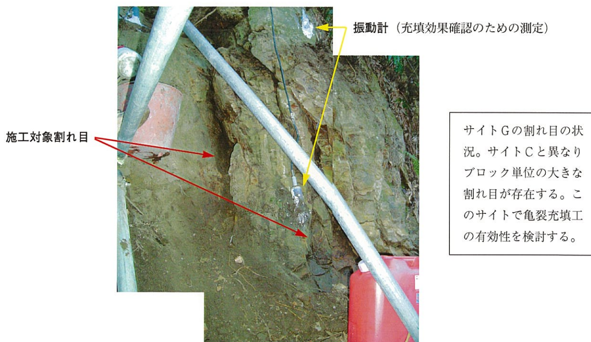
写真 5-5-1 割れ目状況 (施工前)
