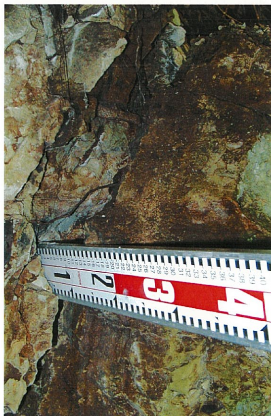
サイトCの亀裂の発達の状況(2) 割れ目の幅は10cm以上の箇所もある。
