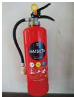
しょうかき 消火器
