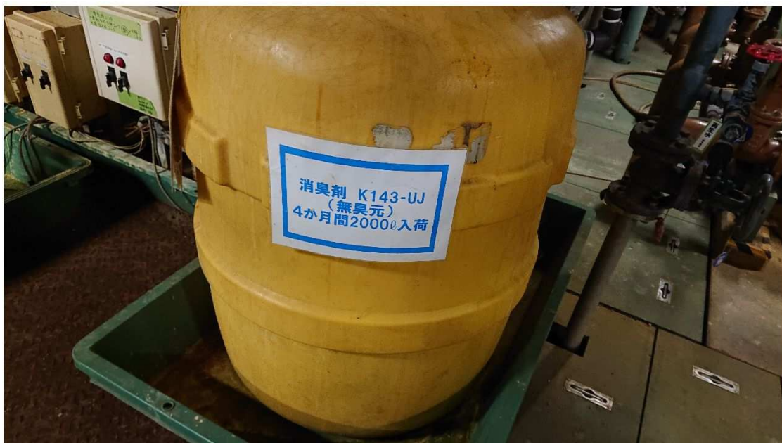
写真 2-8-2-3 汚泥用消臭剤
