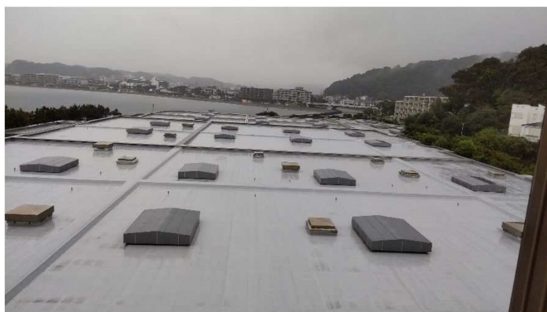
写真 2-8-2-2 水処理施設二重覆蓋
