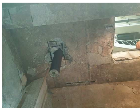
写真：汚泥貯留槽の鉄筋露出
