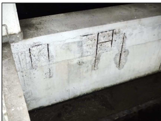
写真：3系水処理の水槽部鉄筋露出
