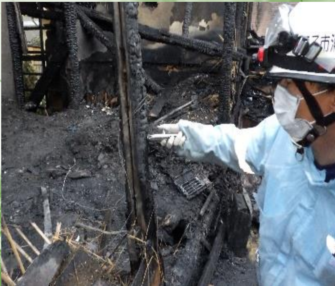
鎮火後の火災現場
