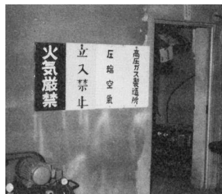
空気ボンベ充填室
